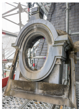
Le parement d'un œil-de- bœuf avant sa restauration Novembre 2024
